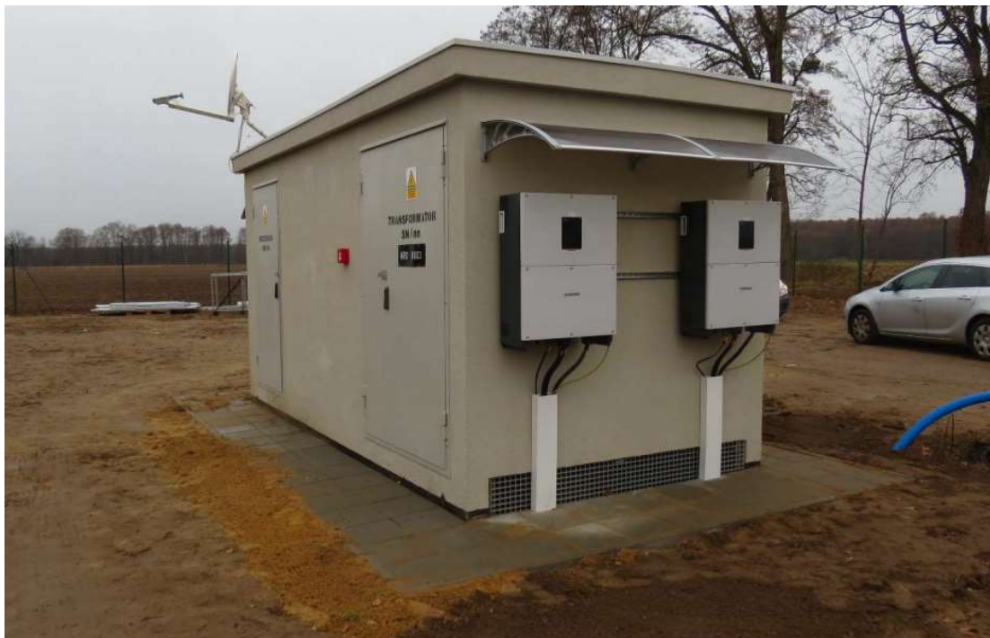
Ryc. 6. Falowniki (inwertery) zainstalowane na stacji transformatorowej SN Źródło: Materiały Inwestora
