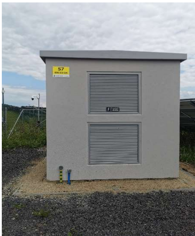
Ryc. 9. Przykładowy budynek kontenerowej stacji transformatorowej Źródło: Materiały Inwestora
