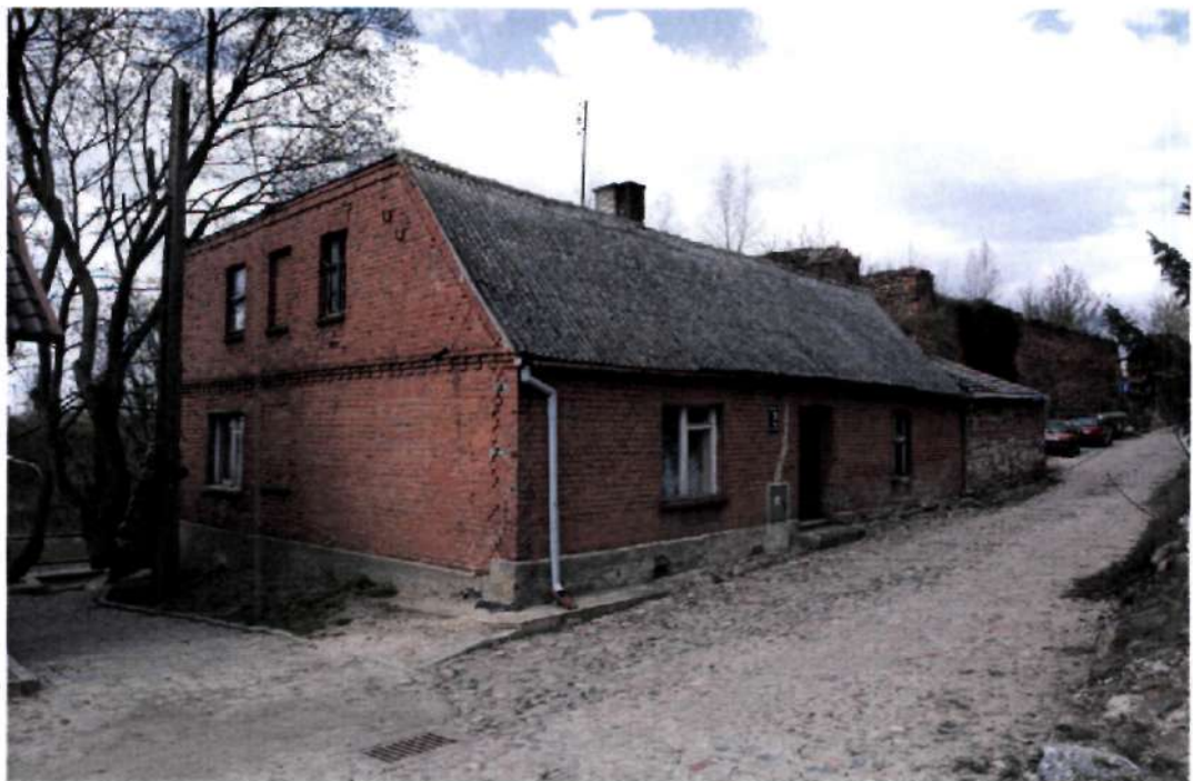
Rysunek 46. Budynek komunalny przy ul Barlickiego charakteryzujący się bardzo złym stanem technicznym, Pokrycia dachowe z materiałów zawierających azbest. Budynek częściowo wykonany z cegły rozbiórkowej pochodzącej ze średniowiecznych fortyfikacji.
