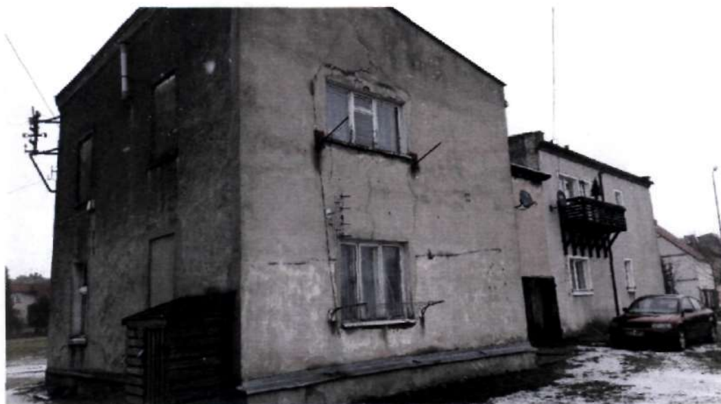
Rysunek 44. Zaniehbany budynek mieszkalny przy ul. Barlickiego
