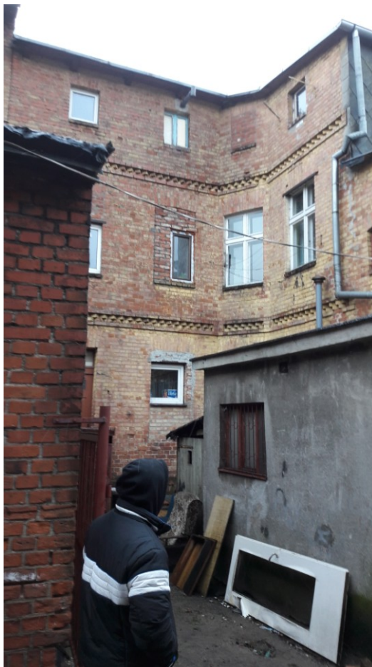
Rysunek 43. Budynek wspólnoty mieszkaniowej przy ul. Traugutta (widok oficyny od ul. Barlickiego)
