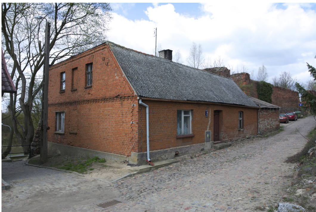
Rysunek 46. Budynek komunalny przy ul Barlickiego charakteryzujący się bardzo złym stanem technicznym, Pokrycia dachowe z materiałów zawierających azbest. Budynek częściowo wykonany z cegły rozbiórkowej pochodzącej ze średniowiecznych fortyfikacji.
