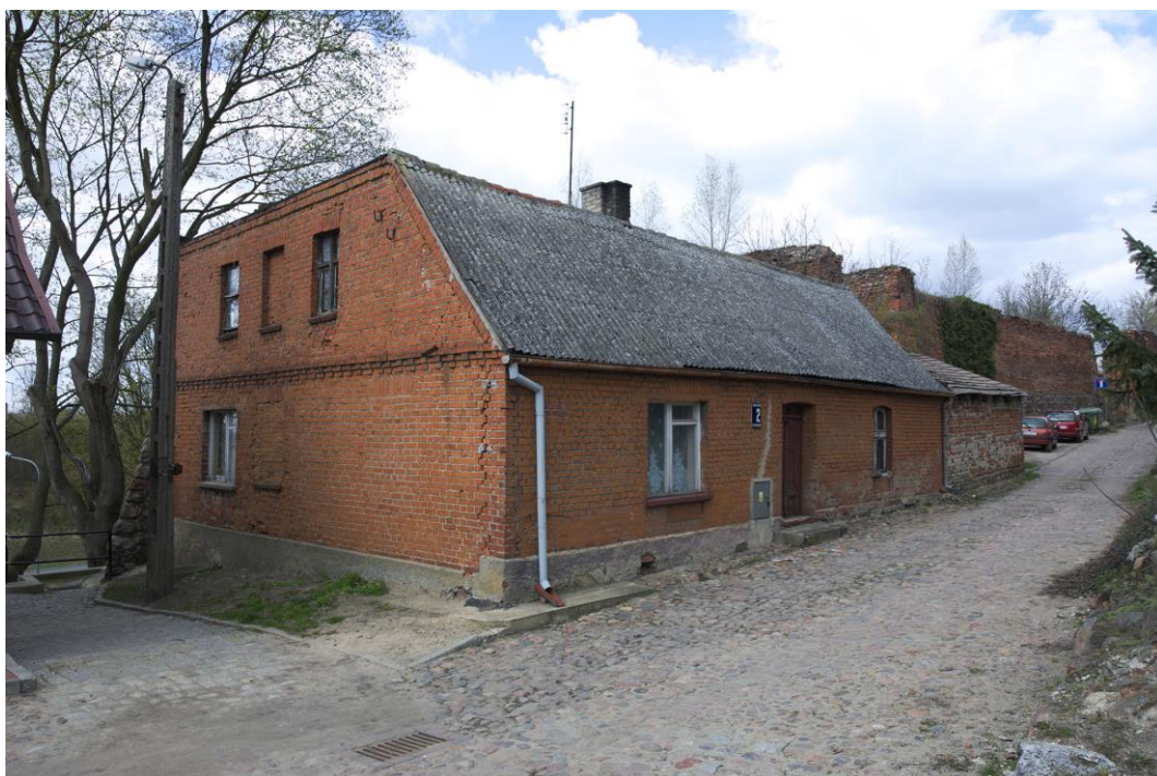
Rysunek 47. Budynek komunalny przy ul Barlickiego charakteryzujący się bardzo złym stanem technicznym, Pokrycia dachowe z materiałów zawierających azbest. Budynek częściowo wykonany z cegły rozbiórkowej pochodzącej ze średniowiecznych fortyfikacji.
